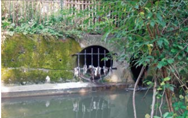
Collecteur d'eau pluviale et ses macrodéchets
