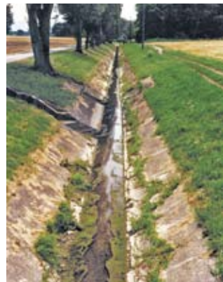
Le corset de béton détérioré
